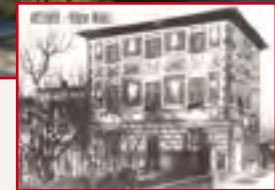
Pietro Neri segnala: Villino Medici in località Anchione, originariamente decorato con pitture su sfondo rossastro, presenti anche nelle stanze interne. Versa in condizioni di precaria stabilità aggravata recentemente dal crollo di una porzione di tetto
